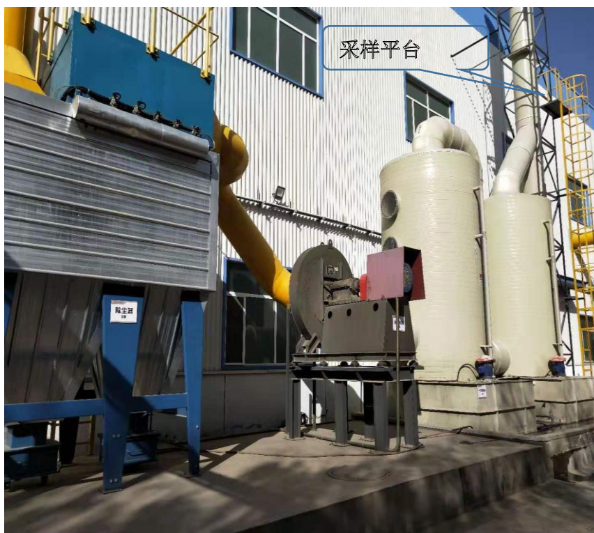
图4-4 废气排放口监测平台
