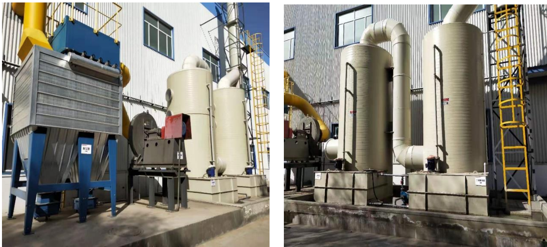
图 4-1 除尘设施及含氟烟气净化塔
