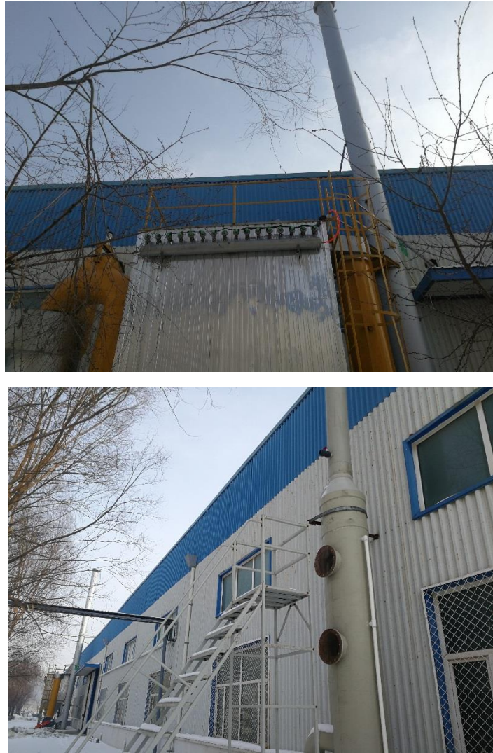
图 4-1 除尘设施及含氟烟气净化塔
